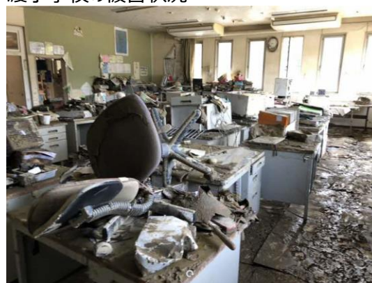
渡小学校の被害状況
