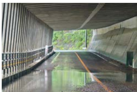
那良口洞門谷水流出
