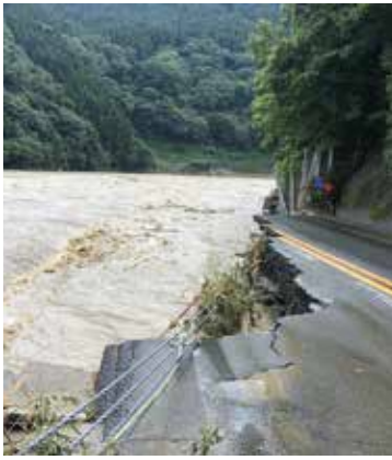
崩落した国道 219 号線 (馬場)
