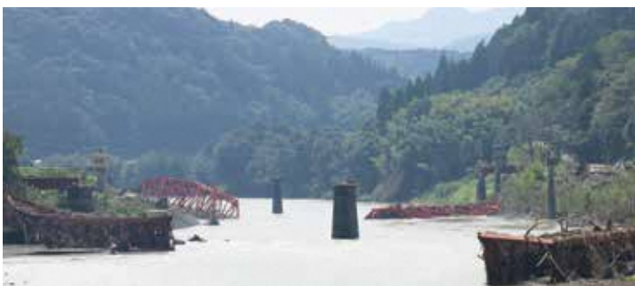
流失した相良橋と第二球磨川橋梁
