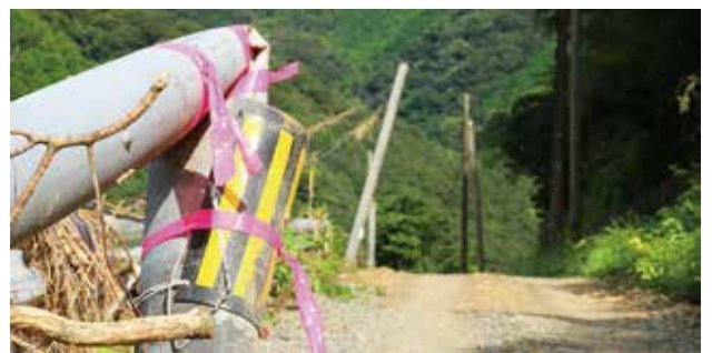
折れ曲がったままの電柱
