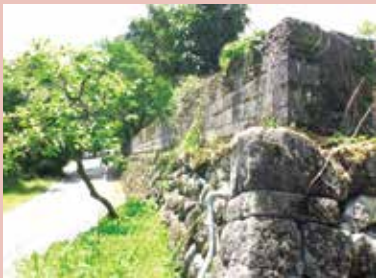
岳本公民館のブロック塀（改修予定）
