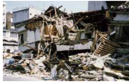
阪神・淡路大震災での家屋被害 出展：（一財）消防防災科学センター
