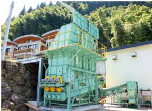
一勝地温泉かわせみに設置された木質バイオマスボイラー
