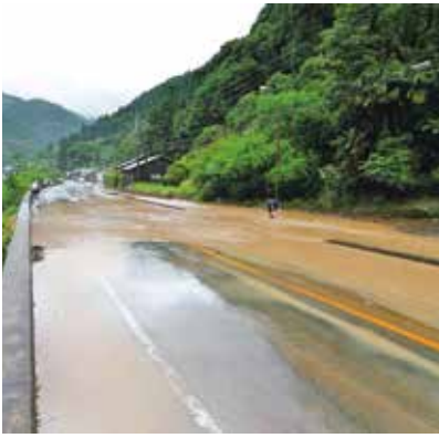
昨年6月の豪雨による国道219号線の冠水
