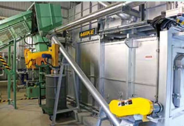
木質バイオマスボイラー
