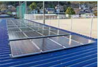
太陽光発電設備
