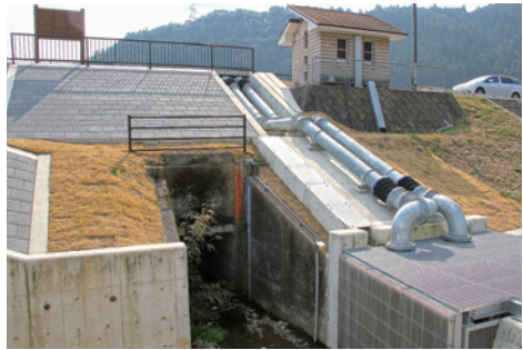
渡地区に配備された内水排水ポンプ
