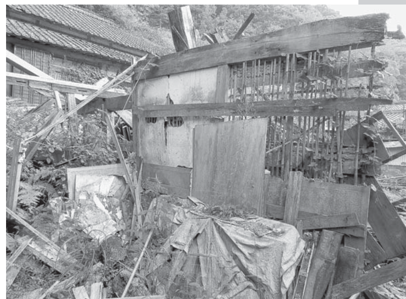
崩壊した廃屋
