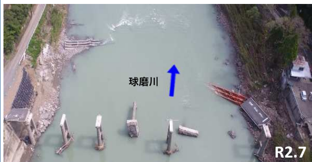
【被災全景写真（神瀬橋）】
