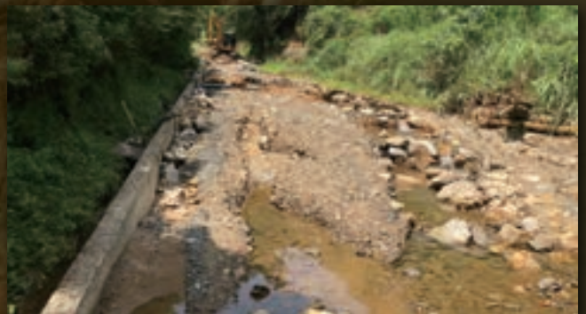
村道横井大瀬線被災状況
