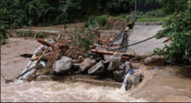
四蔵地区被災状況
