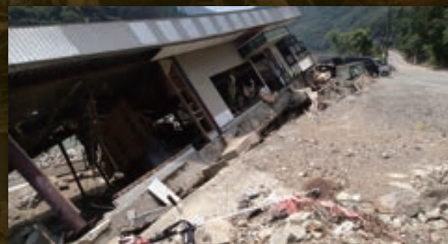
小谷地区被災状況
