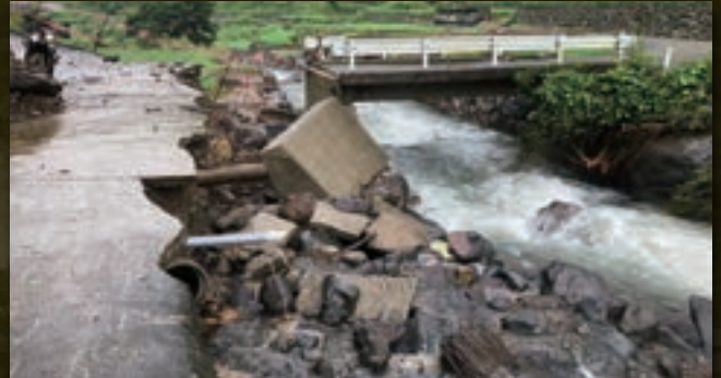
村道第二田代線被災状況
