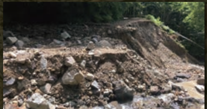
林道川島線被災状況
