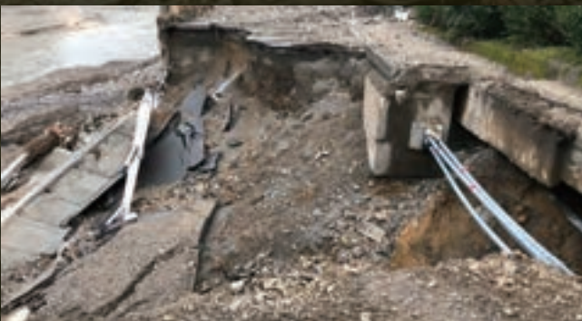
国道219号上郡地区被災状況
