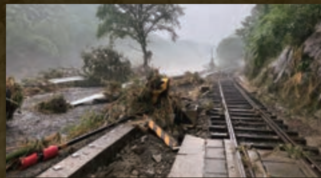
JR肥薩線那良口踏切被災状況
