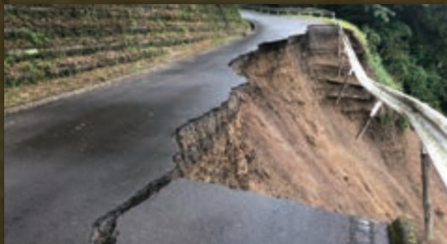
毎床地区被災状況
