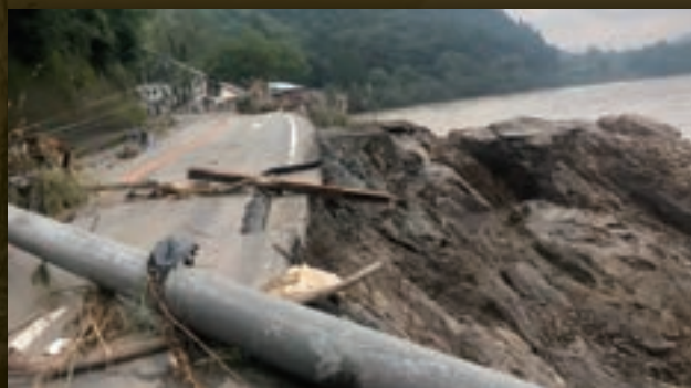
国道219号の路肩や待避場の流失
