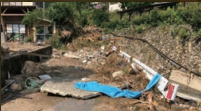
県道高沢一勝地線被災状況
