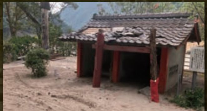
淋地区柴立姫神社被災状況
