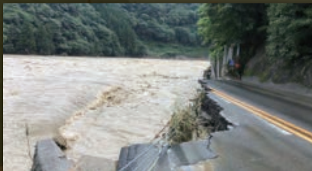
国道219号馬場地区、国道及びロードパーク流失
