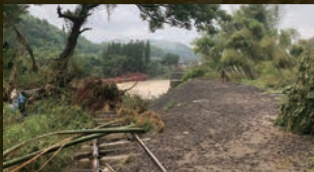
JR肥薩線被災状況
