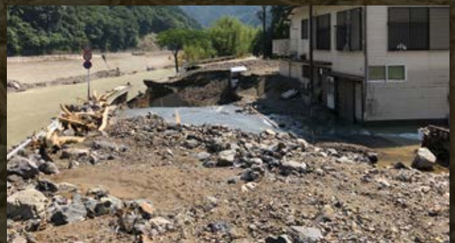
国道219号多武除地区被災状況
