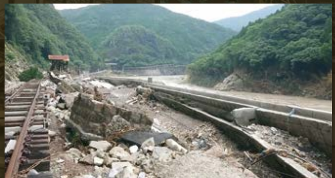
JR肥薩線球泉洞駅付近被災状況
