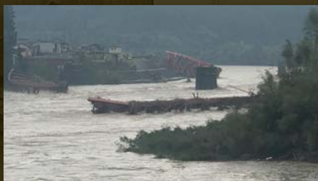
相良橋及びJR肥薩線球磨川第二橋梁の被災状況
