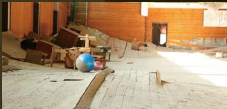
渡小学校体育館、被災後に床が反りあがった様子
