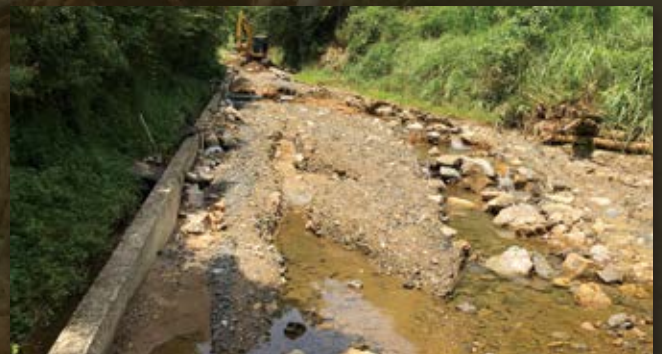
村道横井大瀬線被災状況
