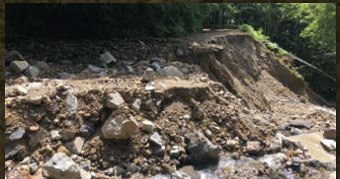
林道川島大岩線被災状況
