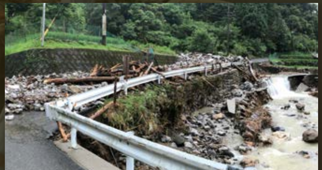
村道沢見線被災状況
