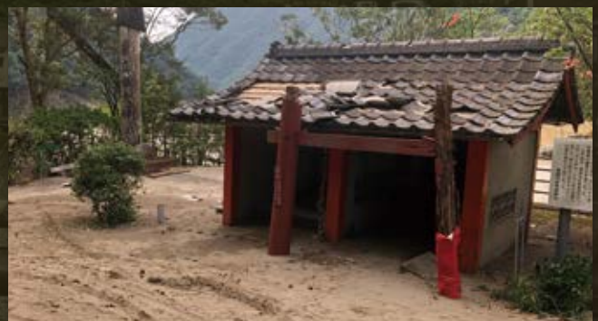
淋地区柴立姫神社被災状況
