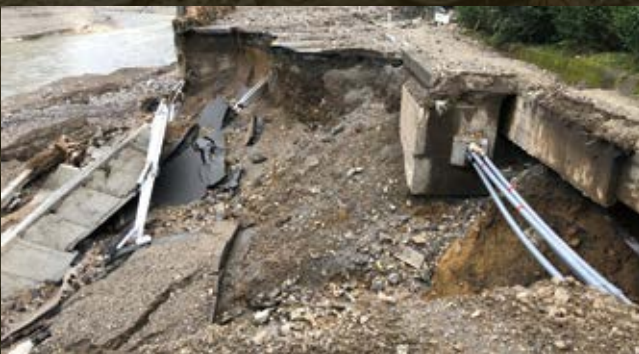
国道219号上部地区被災状況
