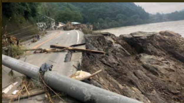
国道219号の路肩や待避場の流失
