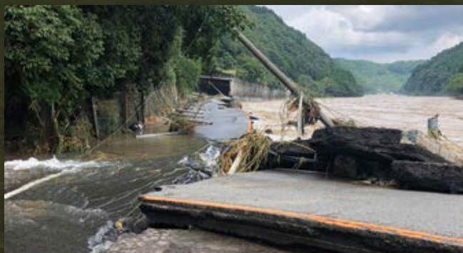
国道219号馬場洞門付近、中央線より球磨川側流失
