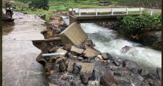
村道第二田代線被災状況
