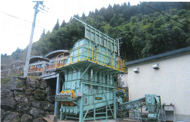
かわせみのバイオマスボイラー
