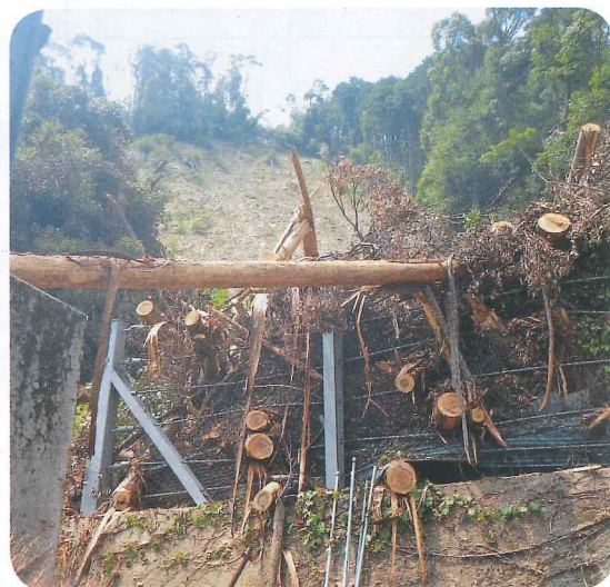
神瀬四蔵地区山腹崩壊現場
