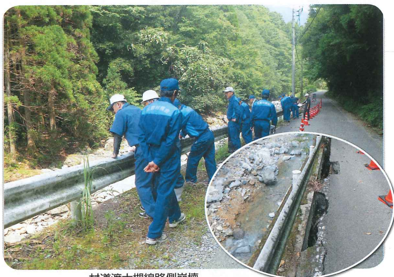
村道渡大槻線路側崩壊
